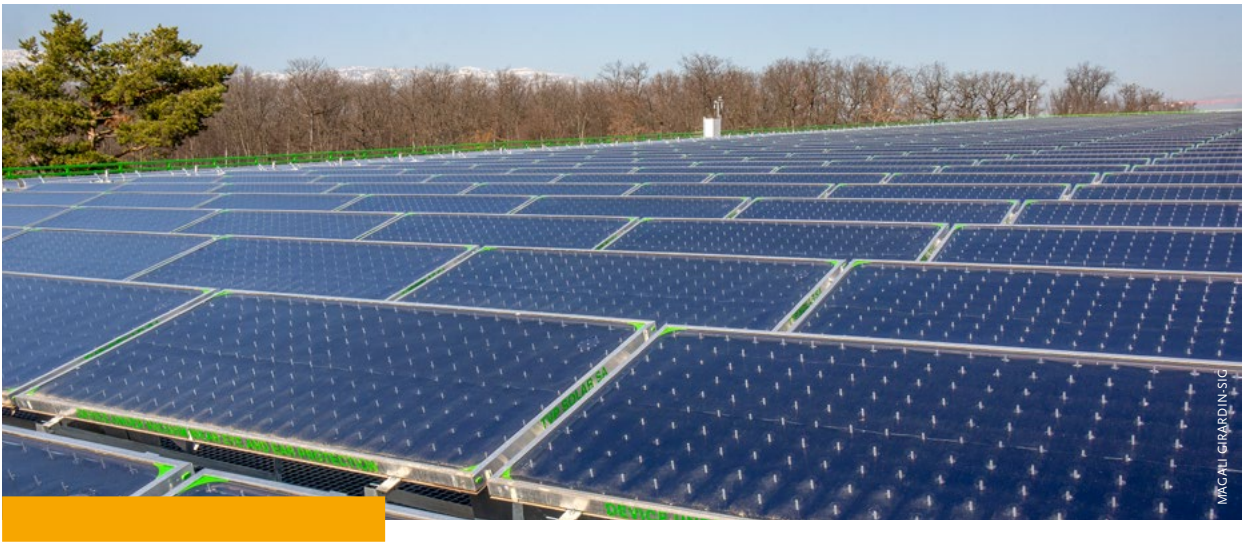
Le 25 février 2021, a été inaugurée la centrale solaire thermique SIG SolarCAD II située au Lignon, sur le site des services industriels de Genève (SIG), un établissement public du canton de Genève (Suisse). D’une surface de 800 m², la centrale produira de la chaleur qui sera injectée dans le réseau du canton. Les panneaux sont équipés de capteurs sous vide fabriqués par la société genevoise TVP Solar.
